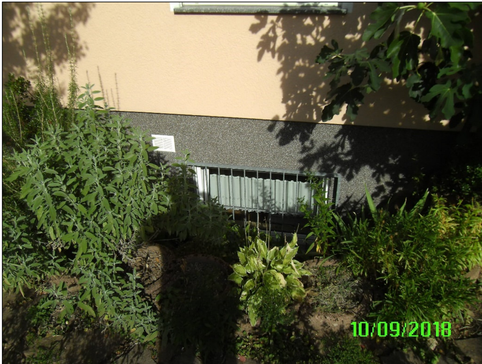
Silvanerstraße – Kellerfenster ohne Schutz
