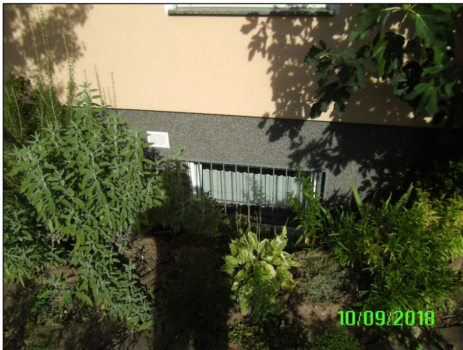
Abb. 25: Silvanerstraße – Kellerfenster ohne Schutz
