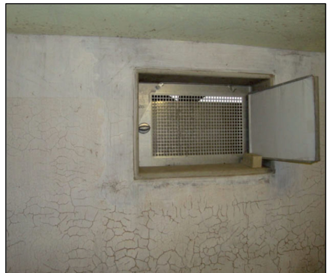
Abb. 39: Nachträgliche Einbauten von Türen und Kellerfenstern zum Schutz vor eindringendem Wasser (ibh)
