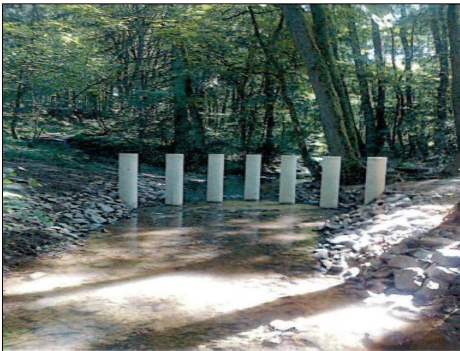
Abb.8: Treibgutrechen vor einer Ortschaft (ibh 2017)
