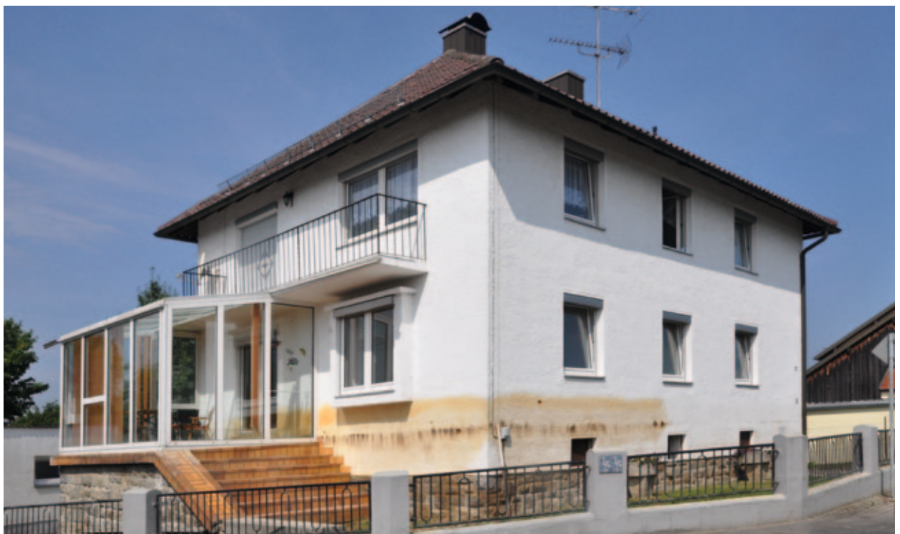
Mit Heizöl belastetes Wärmedämm-Verbundsystem eines Wohnhauses
