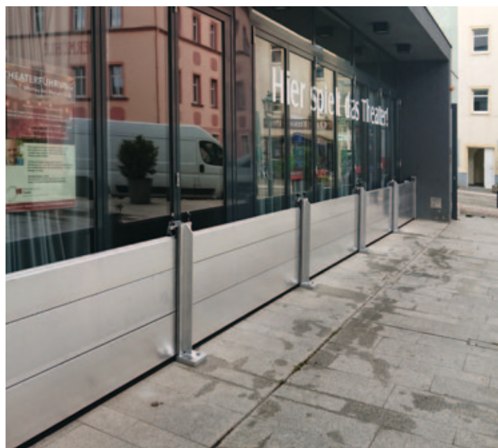
Objektschutz mit teilmobilen Schutzelementen
