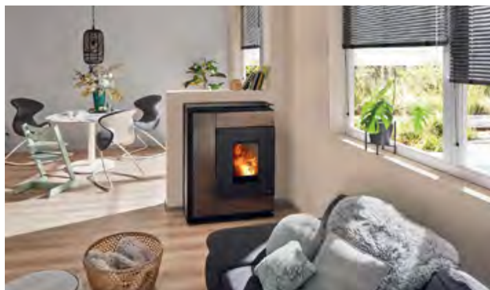
Wer die Wärmepumpe mit einer Holzfeuerung unterstützt, senkt die Stromkosten.
