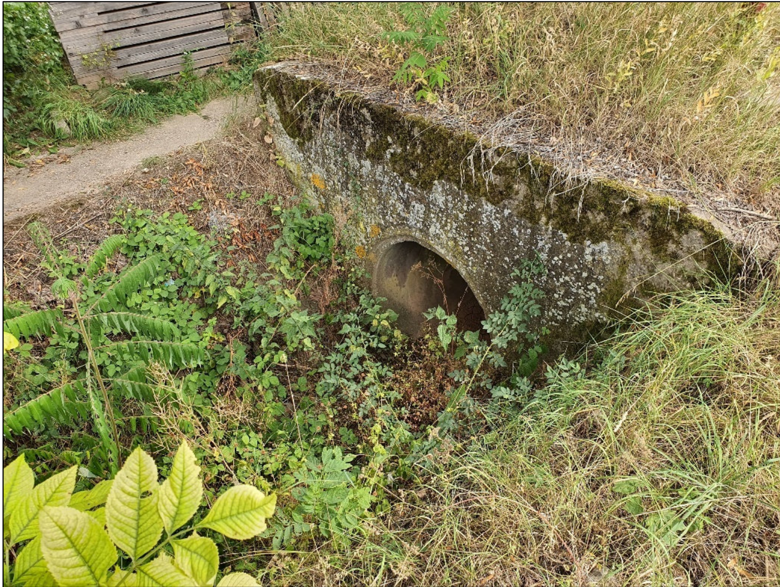
Johannes Würth-Straße: Grabenprofil
