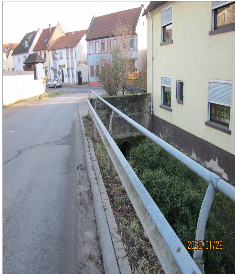
Auslauf Reisbach -Kreuzung Neuoffsteiner Straße
