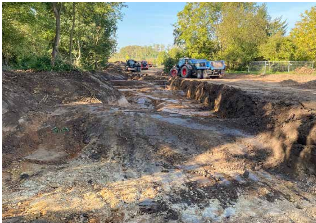
Westlich von Offstein sind die Arbeiten zur Renaturierung eines Abschnitts des Eisbachs bereits in vollem Gange.
