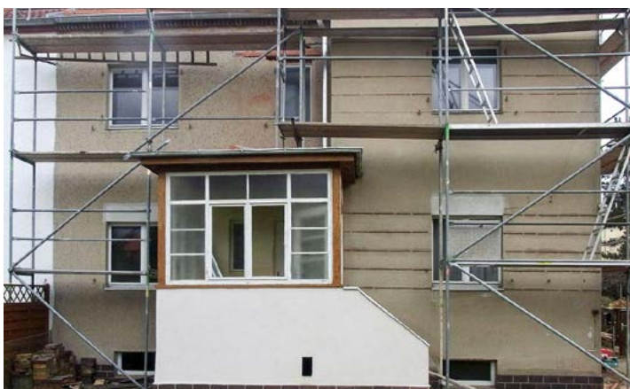
Ältere Häuser haben einen besonderen Charme, aber häufig auch großen Renovierungsbedarf. (Foto: DJD/Bauherren-Schutzbund)
