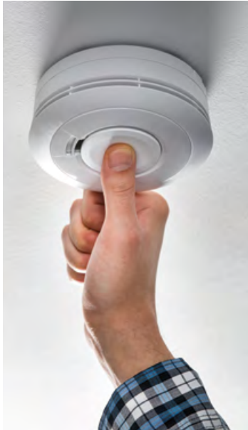
Die Funktionsfähigkeit der Rauchwarnmelder prüft man über den Testknopf. Ertönt ein Signal, ist alles in Ordnung.
