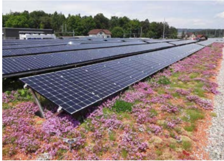
Solare Technik und eine Dachbegrünung: Diese Kombination ist gleichermaßen ökologisch als auch wirtschaftlich sinnvoll. (Foto: djd/Paul Bauder)
