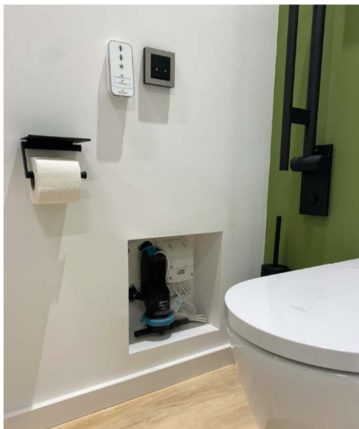
Wegfaltbare Griffe und Notfallsysteme in Griffweite sind wichtige Elemente im pflegegerechten Bad. (Foto: Elements/akz-o)
