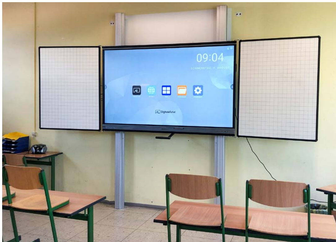
In allen Schulen der Verbandsgemeinde Monsheim wurden moderne digitale Tafeln der Firma Heinekingmedia mit 86“-Monitoren und beschreibbaren Seitenflügeln installiert.
